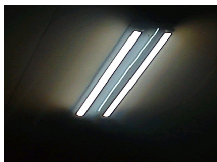
導入したLED蛍光管
